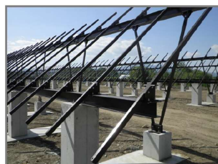
GFRP 製パネル架台 (全区画)
